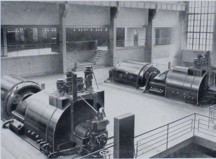
Central productora de energía eléctrica para fines industriales
